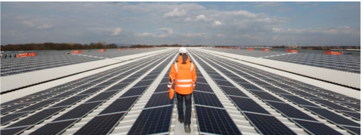
ソーラーセンチュリーの屋根事例：住宅向けに熱と電力の併給、商業施設向けに太陽光発電。
